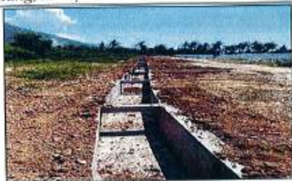
Mương thoát nước mưa nội bộ
