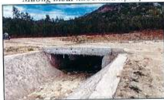
Cống bàn qua đường
