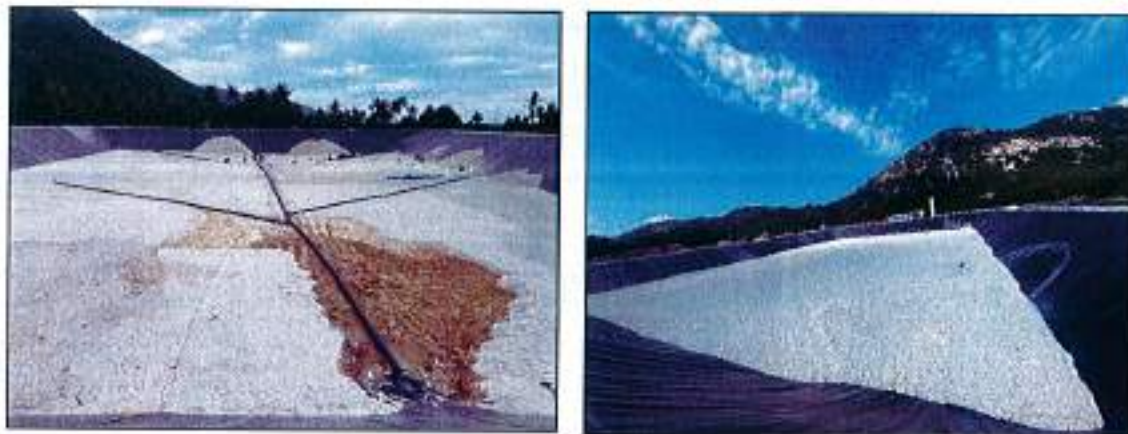
Hệ thống ống thu gom nước rỉ rác
